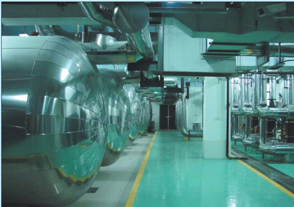
1500 kW teljesítményű hűtőenergia tárolók
