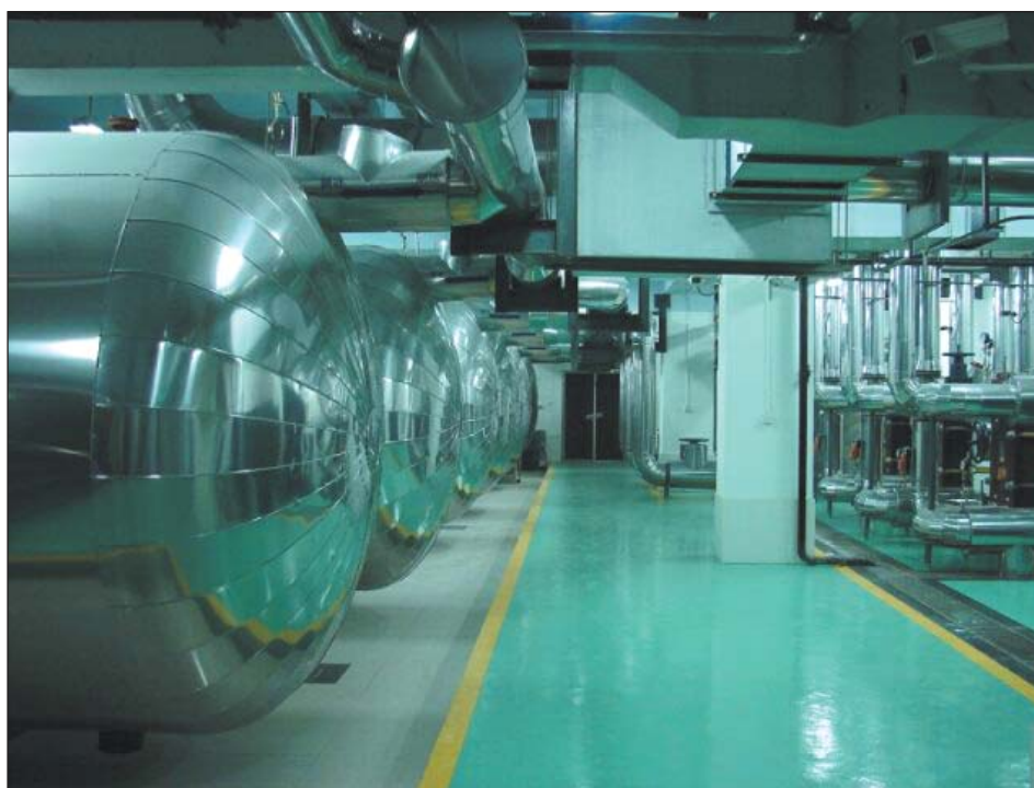
1500 kW teljesítményű hűtőenergia tárolók
